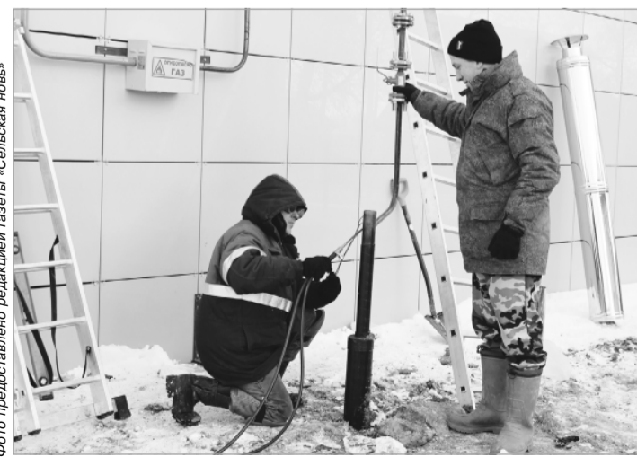
Сотрудники «Газпром газораспределения Тверь» выполняют работы для подвода газа к МФЦ в г. Красный Холм
